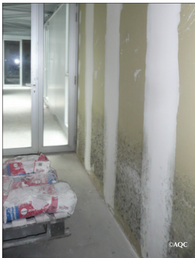
Figure 1. Développement de moisissures sur des plaques de plâtre en phase chantier.
